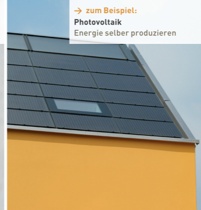
→ zum Beispiel: Luftwärme und Solarstrom Energie und Kosten sparen
